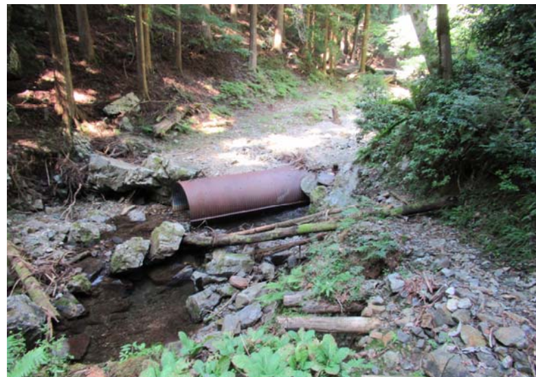
㉖ 片栈橋区間。下部の土砂が浸食されて不安定な状態となっている。
