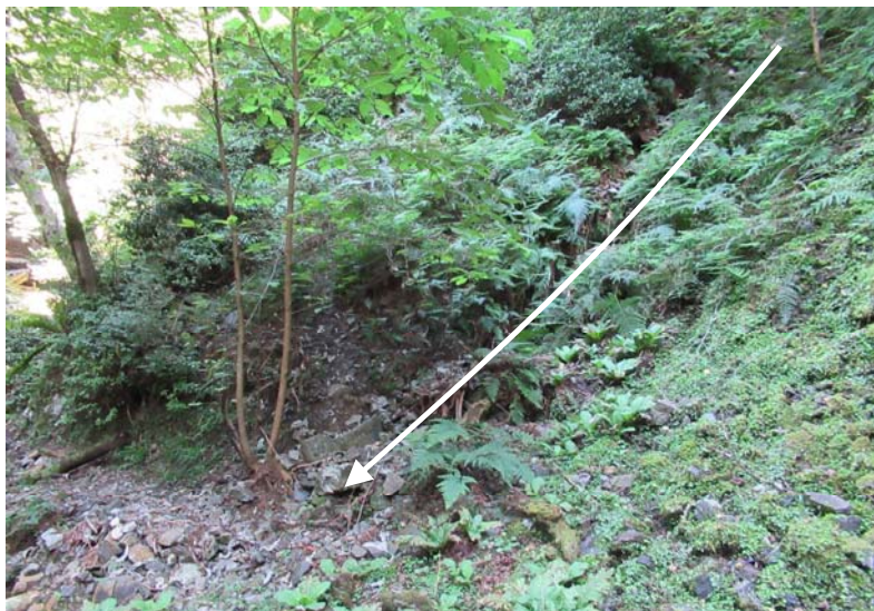
㉕ 仮橋の下流側起点付近では、溪流の崩壊が認められる。
